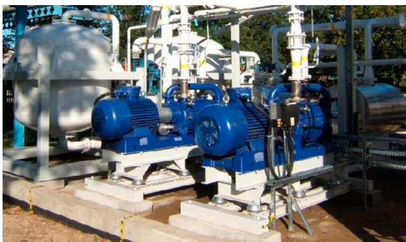
Насос PW.7.24 в установке улавливания паров топлива в хранилище
